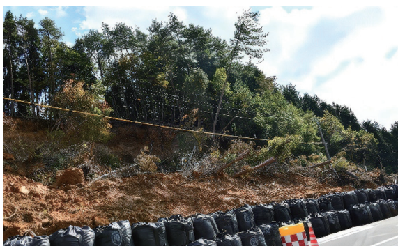
辰巳峠岡山県側 崖崩れの状況
