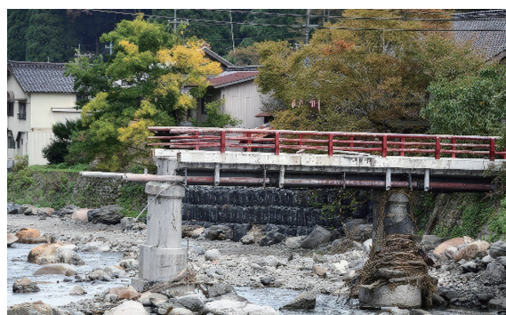
佐治町中心部 橋の崩落2
