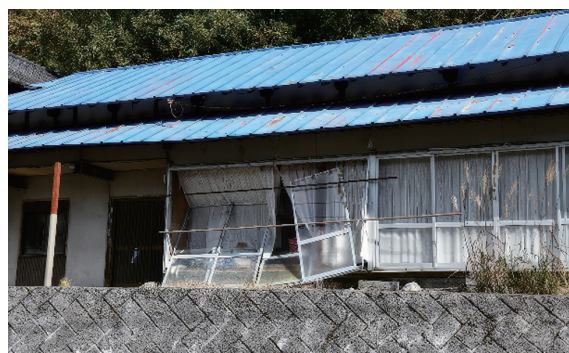
岡山県側 民家の被害
