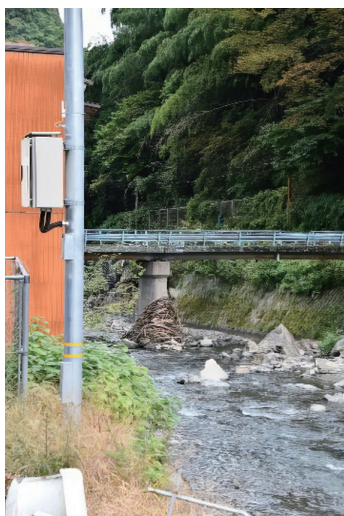
佐治川下流 橋桁への流出物付着
