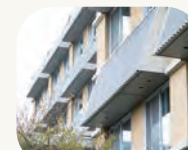
ソーラーウォール パネルを外壁に設置して、空 気を温め、暖房に利用します。
