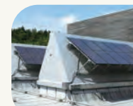
太陽光発電システム 光エネルギーをソーラーパネルで吸収し、電気に変換します。
