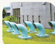
クールヒートチャンバー 地下熱を利用して冷暖房の 負荷を減らす設備です。
